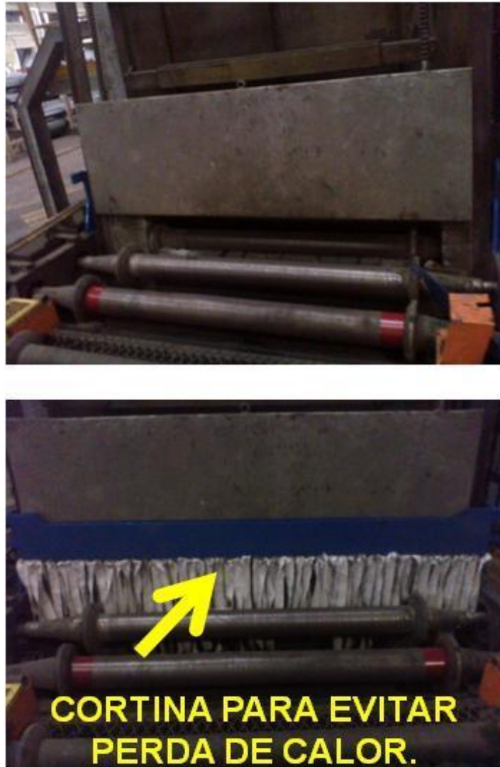
Figura 25 – Cortina para evitar perda de calor na mesa do Forno de barras
