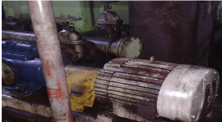
Figura 16 - Bomba Central de óleo lubrificante
