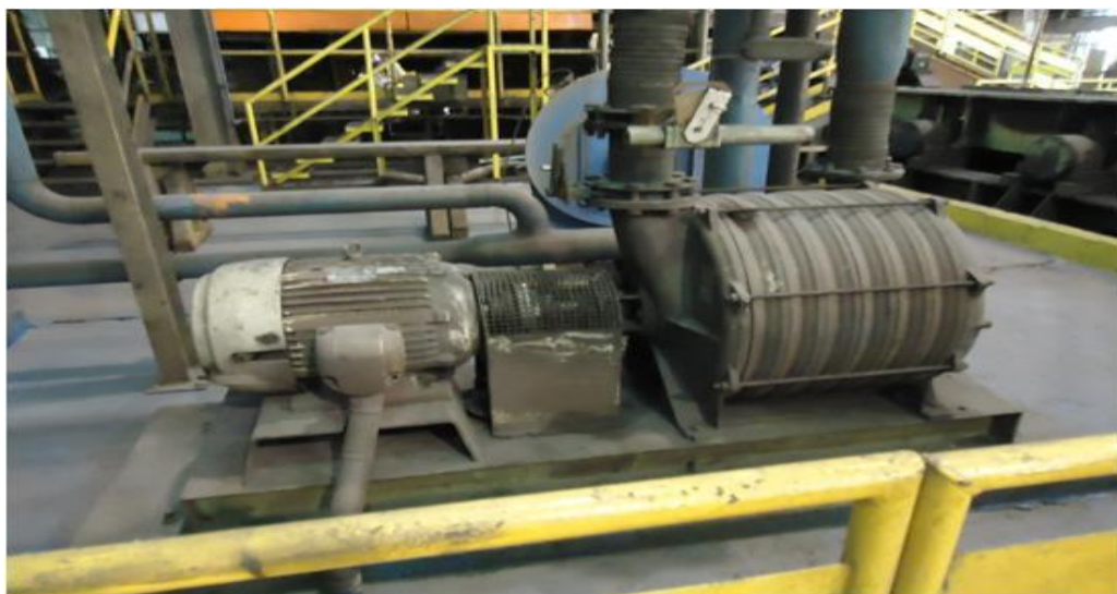
Figura 17 - Motor Sistema de ar de purga da Máquina de Escarfagem
