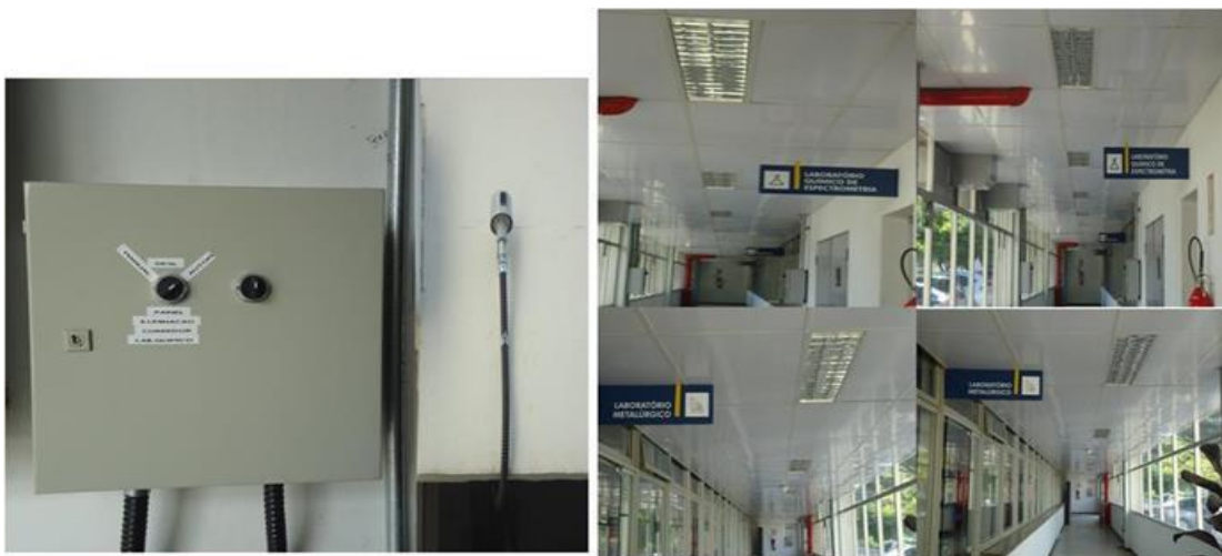
Figura 22 – Sistema de Iluminação Prédio Administrativo
