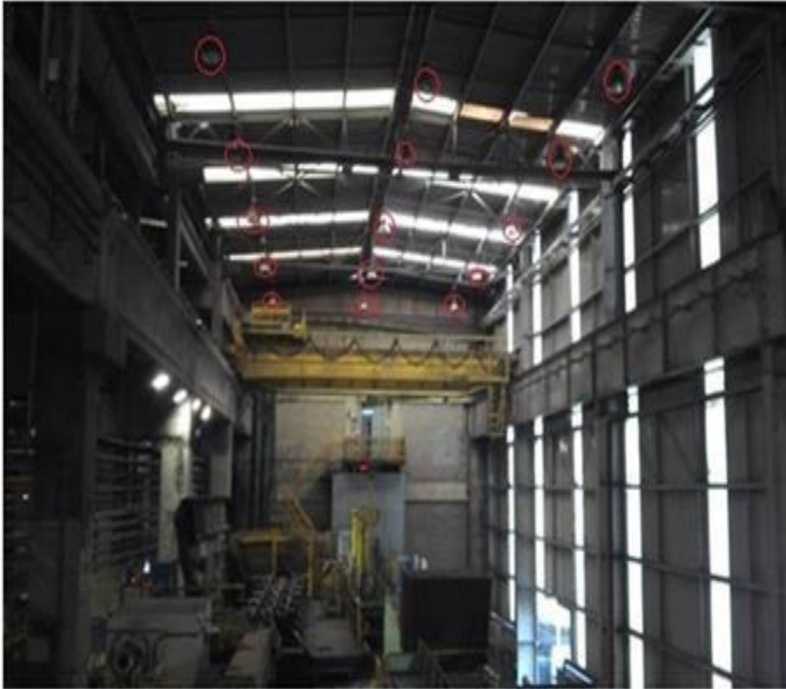
Figura 20 – Luminárias acesas no Galpão do Bloco BGV da laminação
