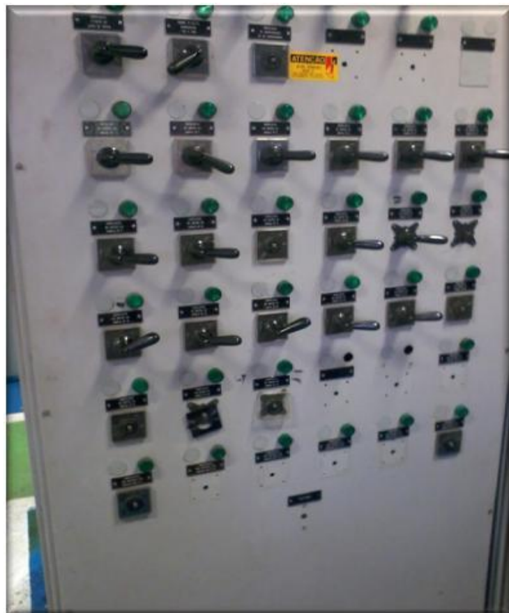
Figura 18 – Acionamento trocadores de calor dos motores de Laminação
