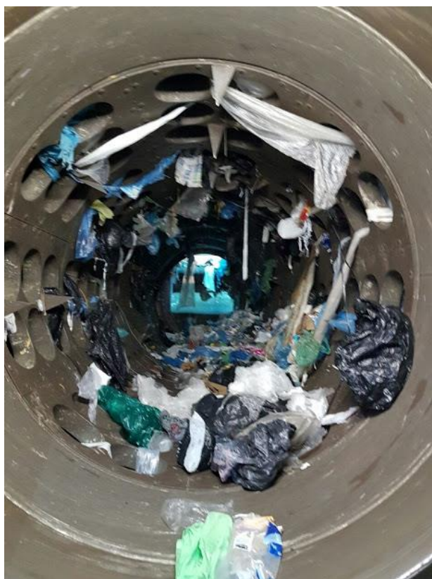
Figura 19. Vista interna da Peneira Rotativa (Oliveira, 2019).
