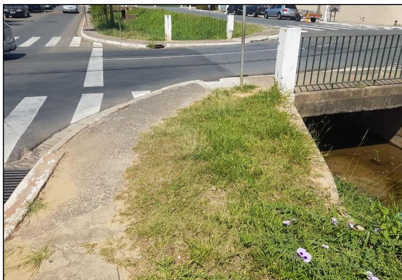
Figura 21 - Ponto de inundação na área urbana do município de Porto Feliz (01/10/2019).
