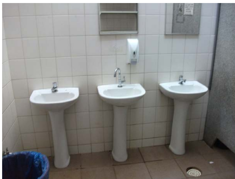
Figuras 13 – Pias do banheiro da entrada da Biblioteca
