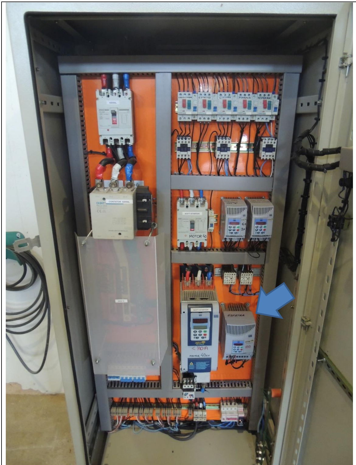
Figura 14. Destaque para o inversor da esteira do painel elétrico.
