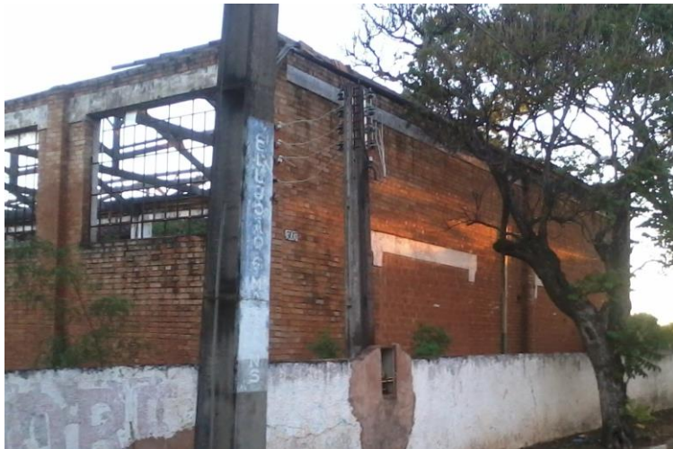
Figura 9: Aberturas obstruídas e esquadrias remanescentes
