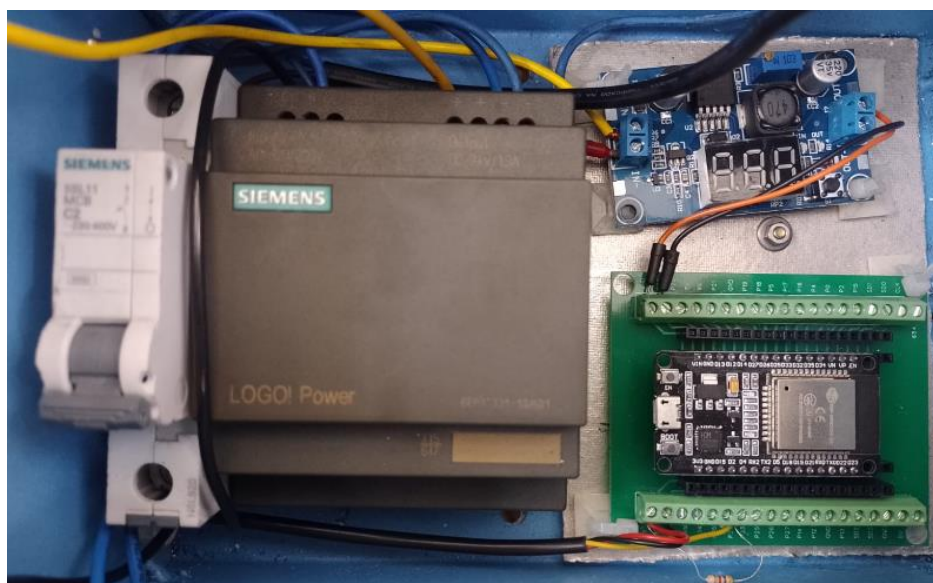
Figura 11- Interno do painel elétrico com o sistema de coleta de temperatura da água
