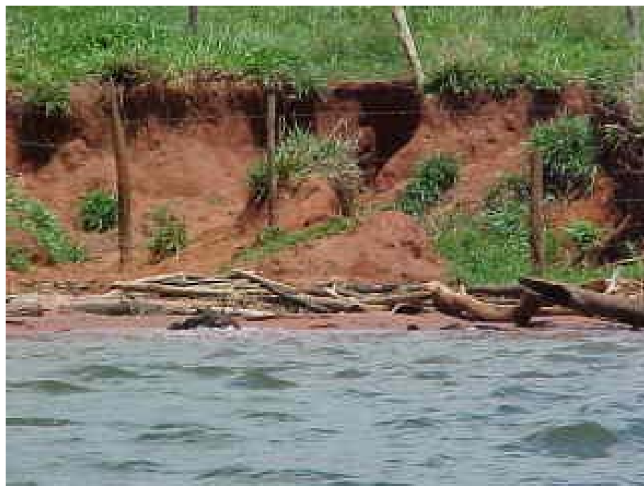
Foto 12: Processo erosivo configurado na margem do Rio Paraná – Anaurilândia – MS (Oliveira, W. 2001)
