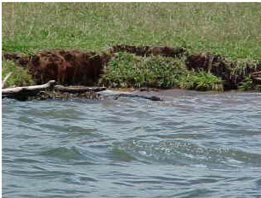
Foto 13: Erosão regressiva na margem do Rio Paraná – Anaurilândia – MS (Oliveira, W. 2001)
