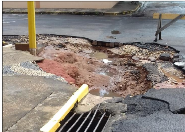
Figura 36 – Parte da calçada e rua erodidos pela concentração de água das chuvas em janeiro de 2017, localizada no cruzamento da rua Joaquim Nabuco com a Alameda Santa Cruz (Coordenadas aproximadas: E 492013 m e N 7601960 m)
