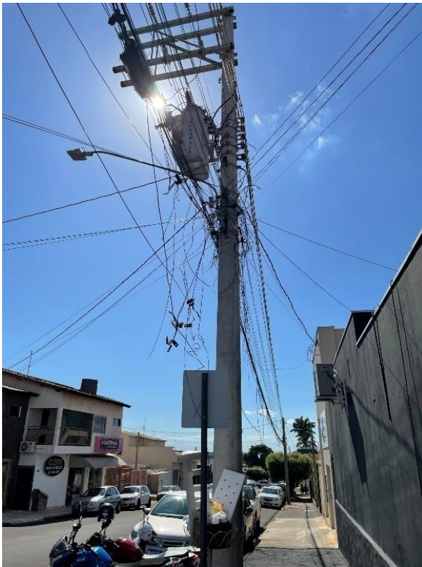
Figura 23: Rede elétrica do município (3).
