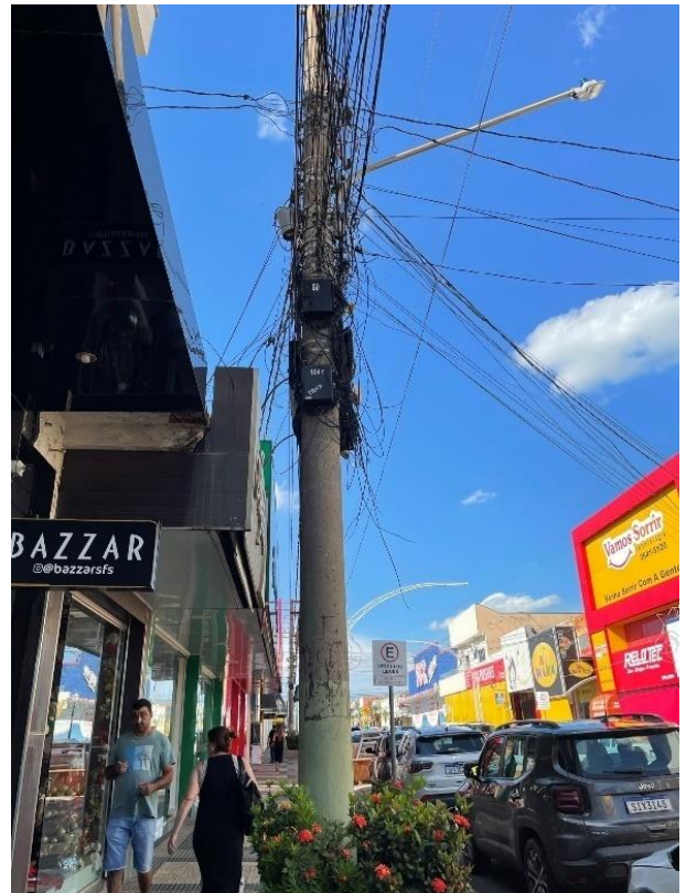
Figura 24: Rede elétrica do município (4).
