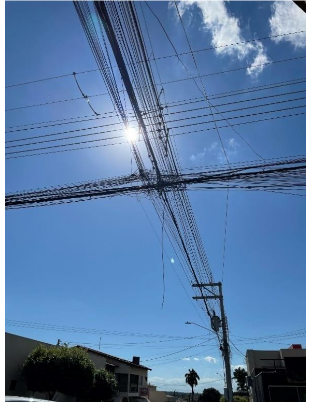
Figura 22: Rede elétrica do município (2).
