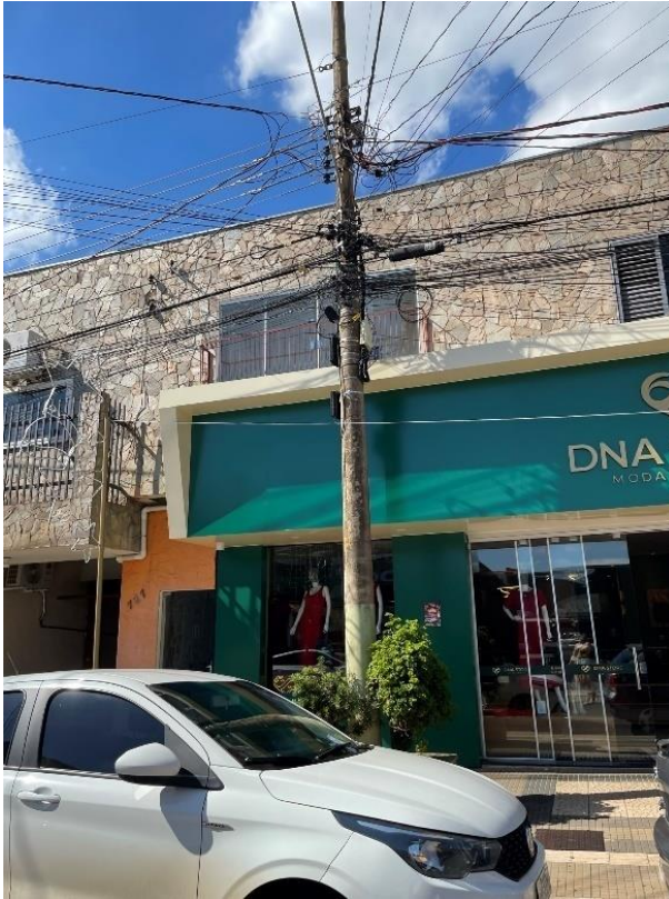
Figura 21: Rede elétrica do município (1).
