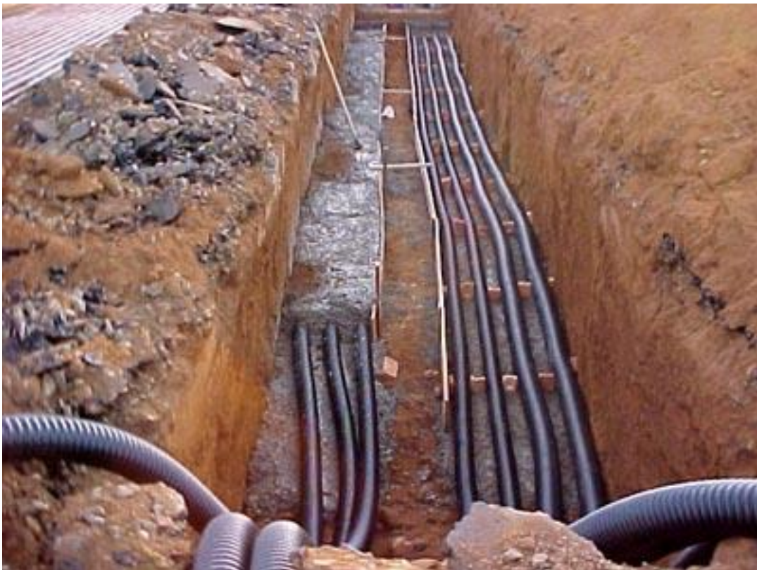
Figura 8 – Rede de energia subterrânea.
