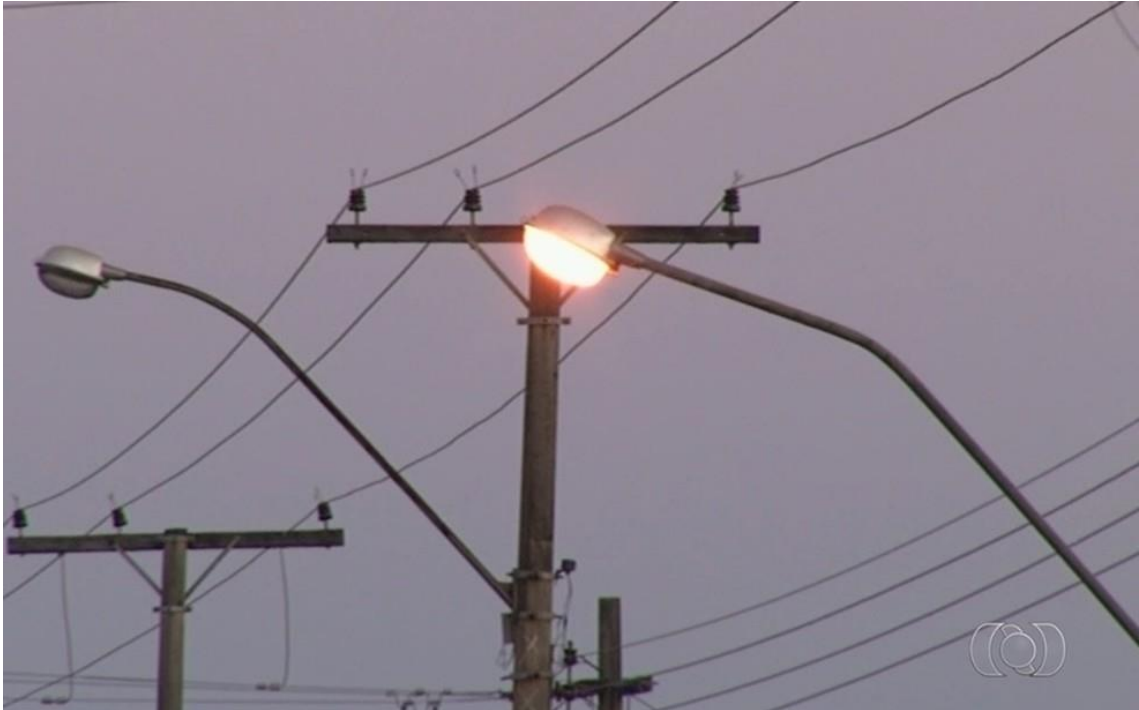
Figura 4 – Linhas de distribuição de energia.
