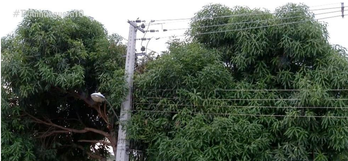
Figura 5 – Linhas de distribuição de energia próximo à galhos de árvores.
