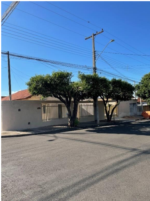
Figura 27: Rede elétrica do município (7).
