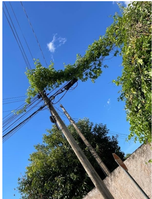
Figura 28: Rede elétrica do município (8).
