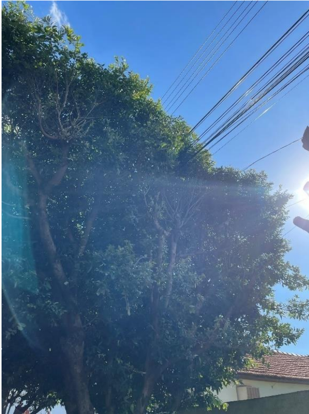
Figura 25: Rede elétrica do município (5).
