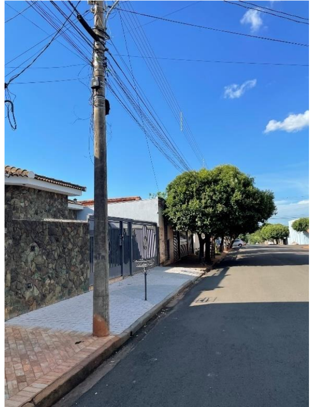
Figura 26: Rede elétrica do município (6).
