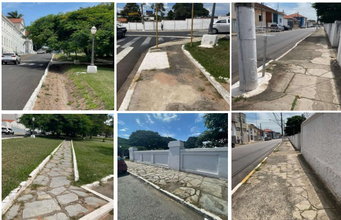
Figura 34 - Itu, exemplos de calçadas com contrapiso de cimento ou outros materiais inadequados nas faces de quadra 209A, 209B, 209C, 211A, 509A e 809B, respectivamente.
