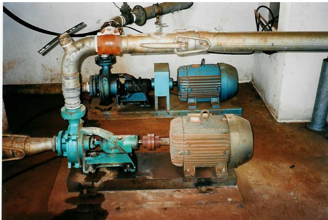
FIGURA 3. Bomba d'água com motor de indução trifásico de 25 CV acoplado.
