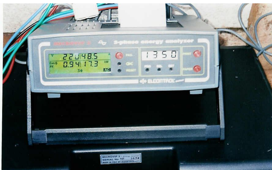
FIGURA 4. Medidor de energia.
