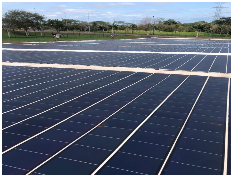
Figura 5 - (UFV 3) Painéis Flexíveis próximo a portaria
