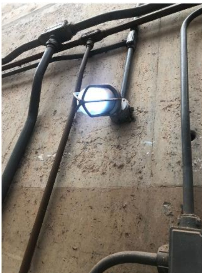
Figura 45 - Iluminação de emergência da UHE Porto Primavera.
