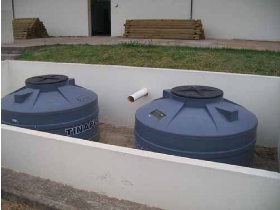
Figura 5 - Tanques de armazenamento de soluções nocivas.
