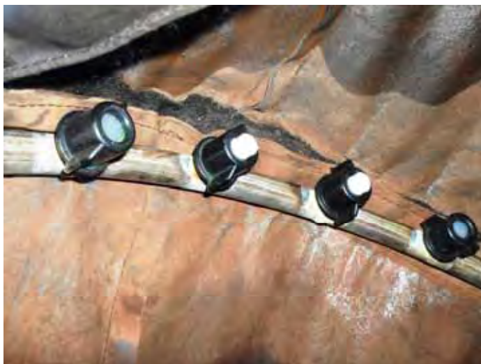
Figura 14. Foto do ramal na parte interna do duto de ar da barra direita demonstrando molhamento da parede logo após as pontas.
