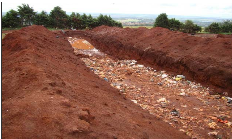
Fotografia 85 – Resíduos sólidos urbanos na vala. Fonte: Do autor (2012).
