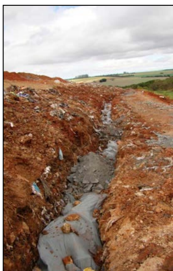
Fotografia 66 - Canaleta para drenagem de chorume. Fonte: Do autor (2012).
