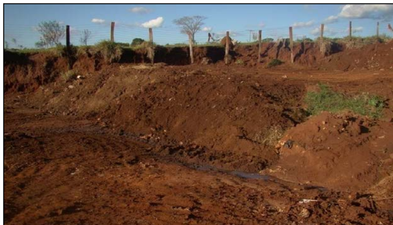
Fotografia 15 - Vala desativada com acumulo de água. Fonte: Do autor (2012).
