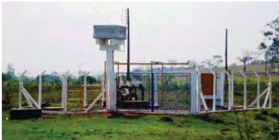
Figura 7 - Estação Elevatória Esgotos (Sabesp-2011)
