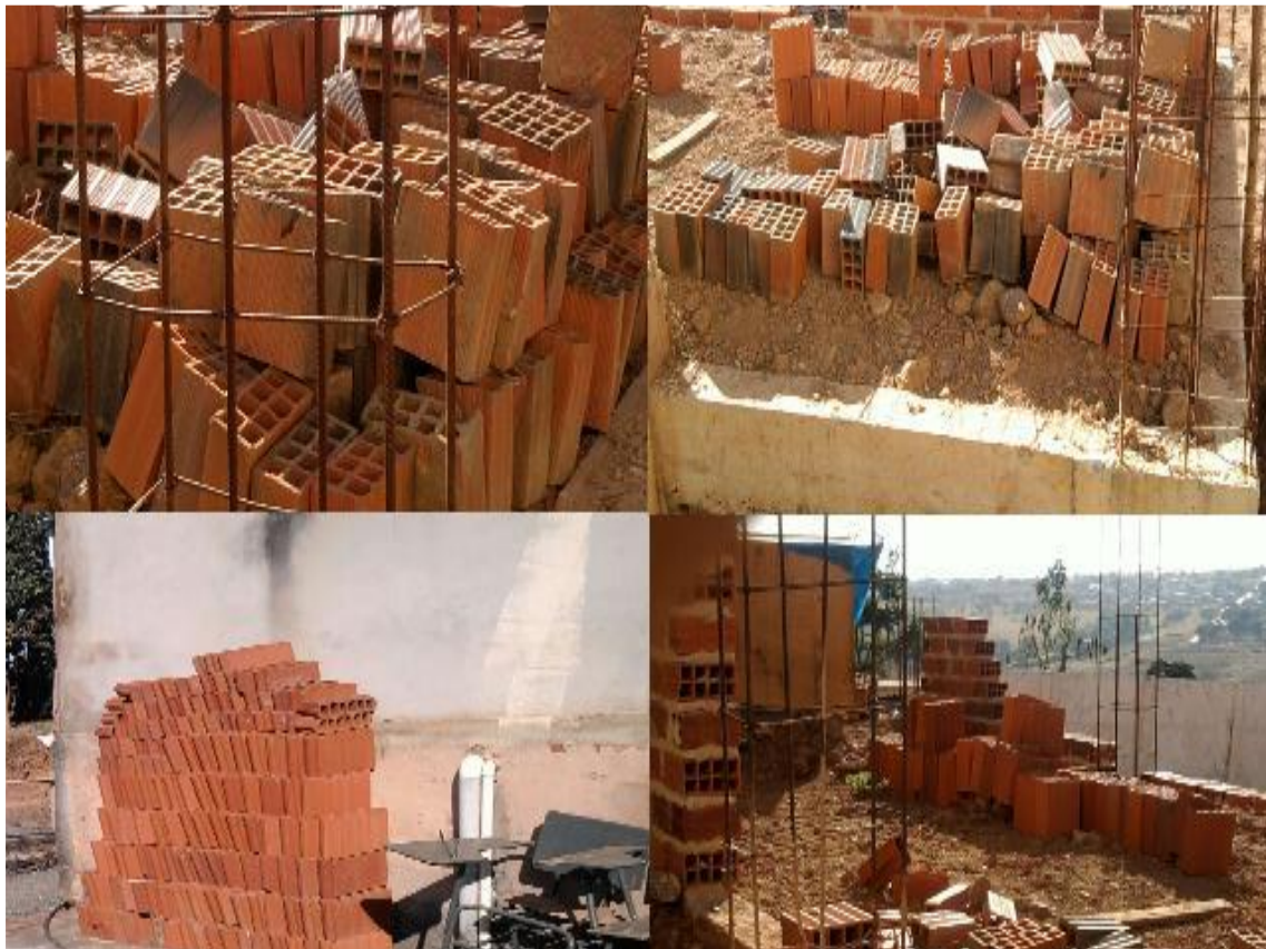
Figura 2: Disposição irregular num canteiro de obra
