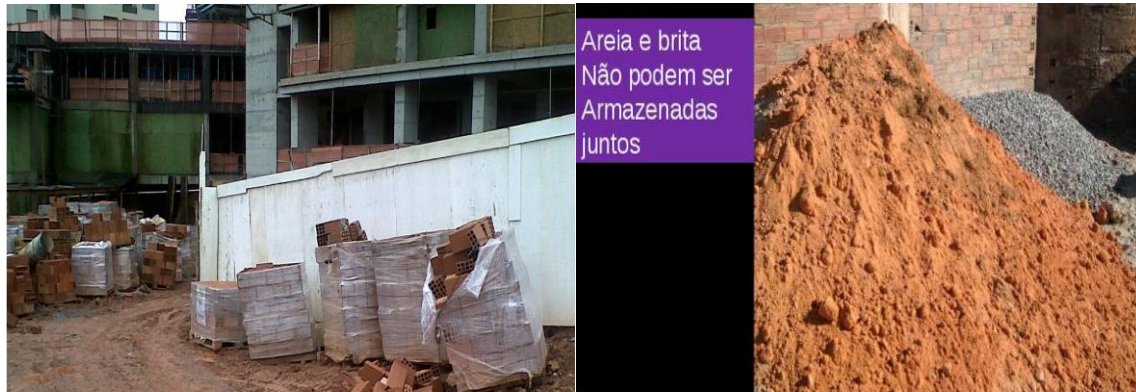
Figura 3: Disposição inadequada de materiais num canteiro de obra
