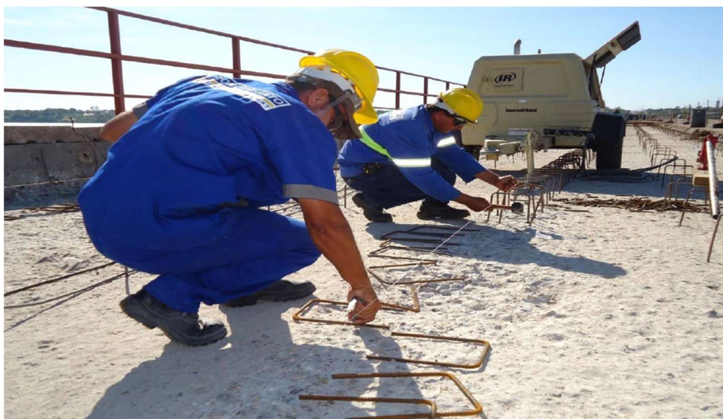
Figura 5: Topo da laje do tabuleiro fresado – Ponte Rodoviária Hélio Serejo
