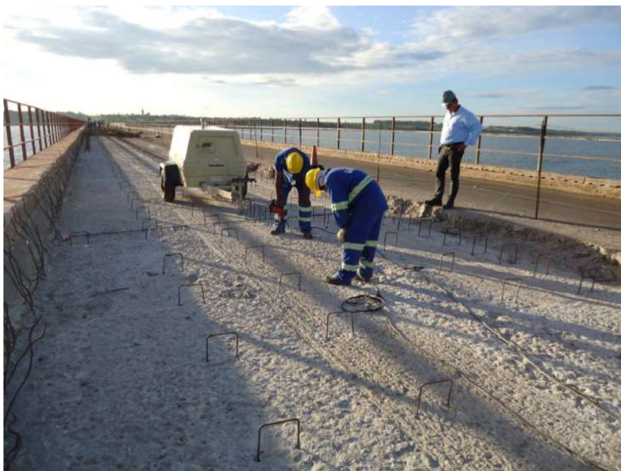
Figura 2: Topo da laje do tabuleiro fresado – Ponte Rodoviária Hélio Serejo
