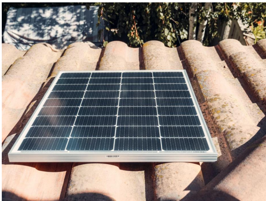
Figura 9 - Painel Fotovoltaico no Telhado de uma Residência.
