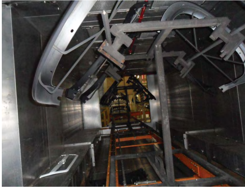
Figura 28 – Estufa de tinta da Cabine de Reparos (Material fornecido pela GM)
