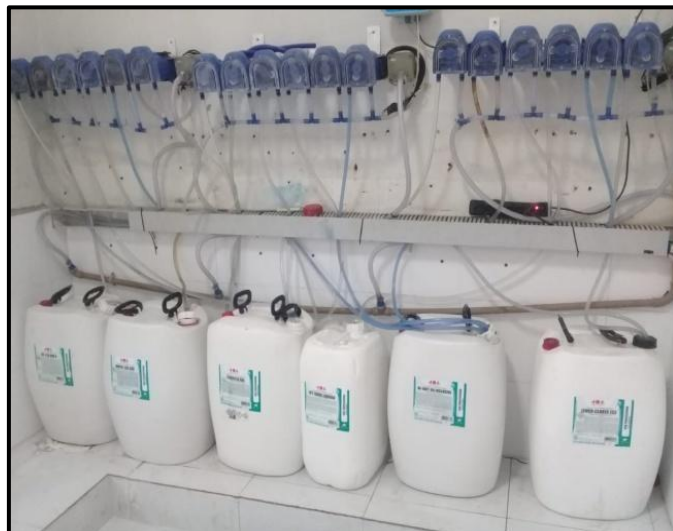
Figura 26 - Bomba dosadora e produtos usados na lavagem na Santa Casa de Misericórdia de Fernandópolis
