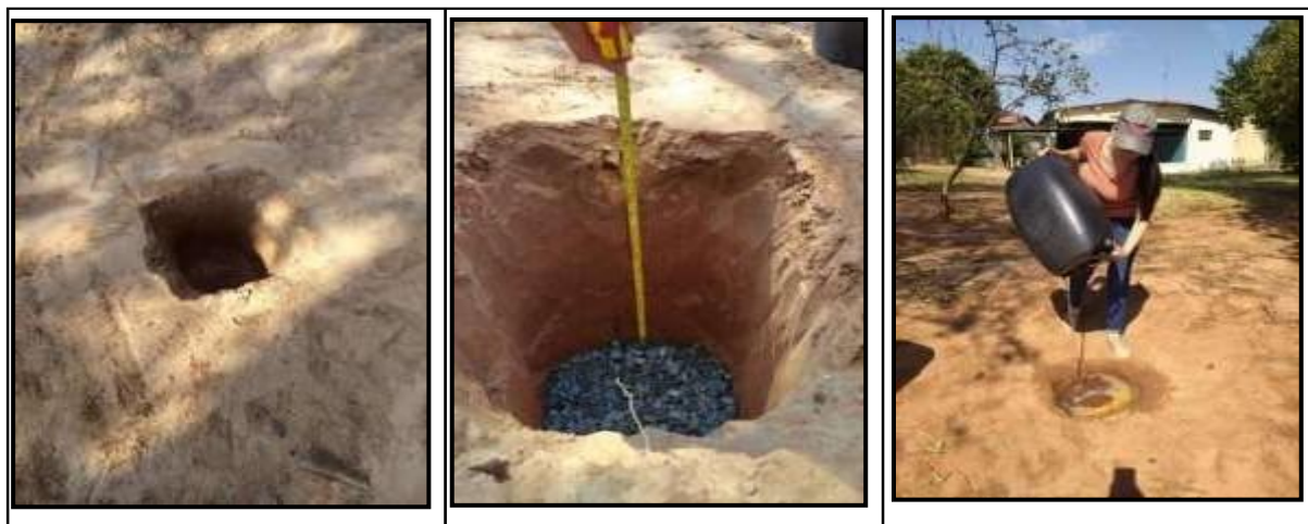
Figura 34 - Teste de infiltração 2 na Santa Casa de Misericórdia de Fernandópolis
