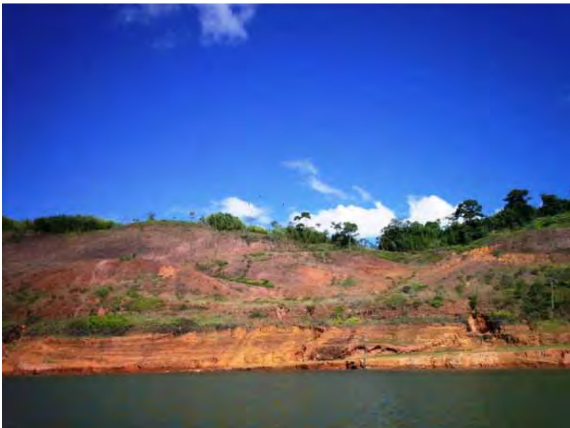
Foto 3: Processo erosivo nas margens da Represa de Chapéu D'Uvas (06/02/2011).
