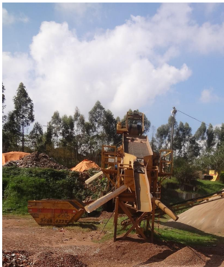
Figura 20 - Usina de Beneficiamento dos RCC. Fonte: Autor
