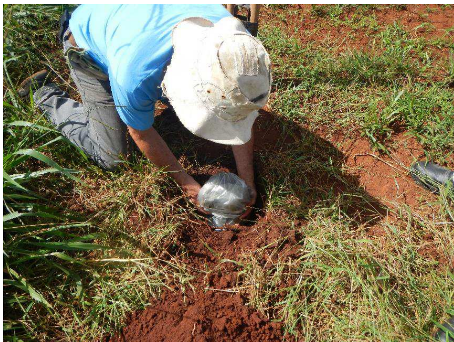
Foto1. Instalação do equipamento de período curto no ponto S01. O equipamento foi enterrado com uma cobertura de solo de aproximadamente 20 cm.
