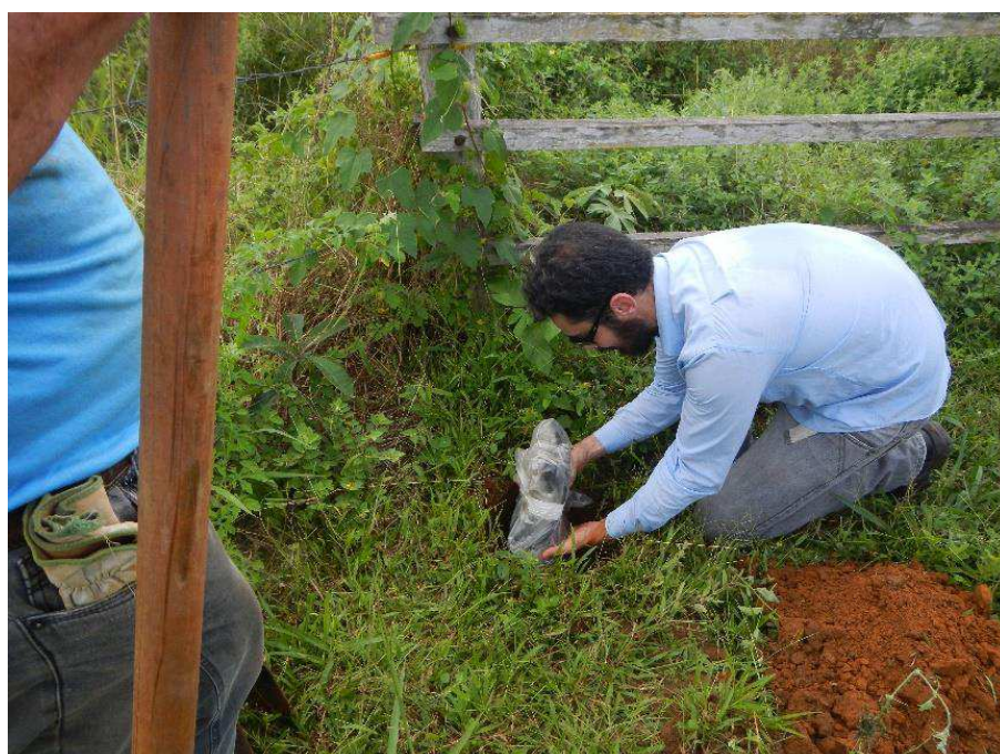
Foto 2. Instalação do ponto S03. O equipamento foi colocado em uma embalagem plástica à prova d'água. Notar a estaca da cerca servindo de referência.
