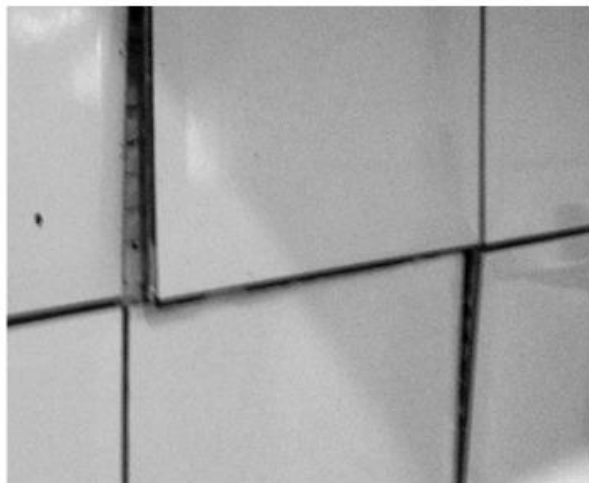
Figura 35 - Deslocamento do revestimento
