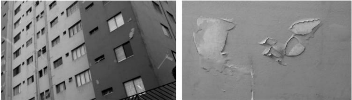
Figura 36 - Deslocamento do revestimento externo
