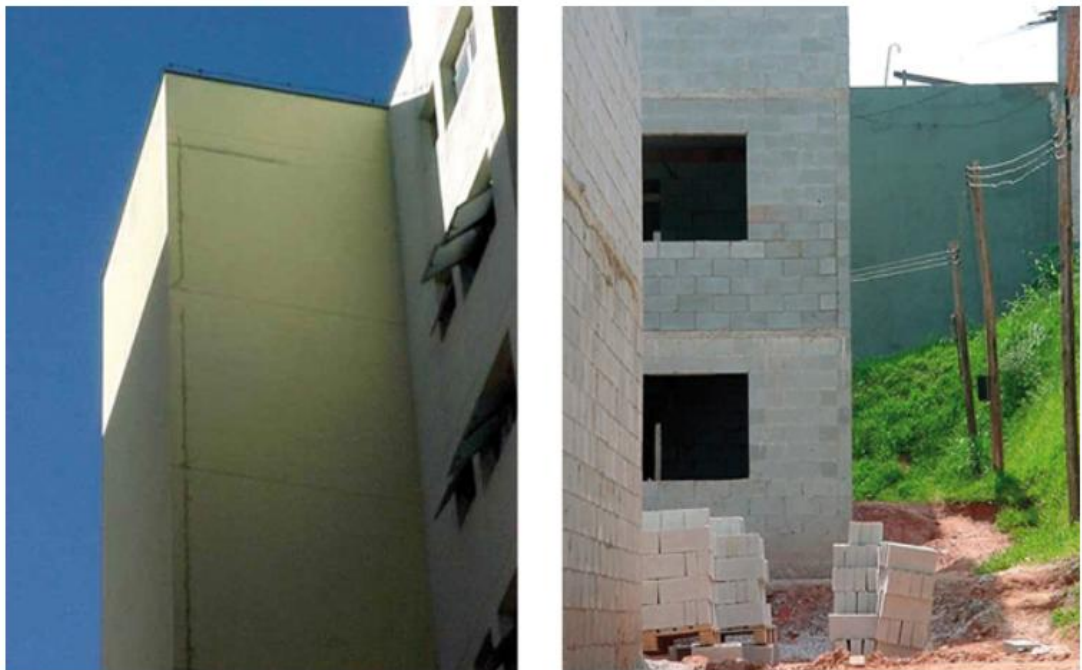
Figura 33 - Fissuras devida falta de amarração entre paredes
