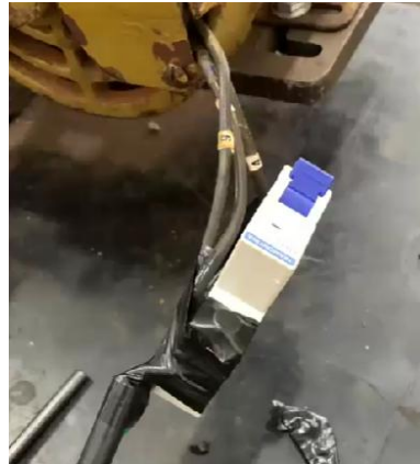
Figura 13 - Disjuntor de ligação da máquina
