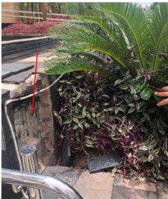
Figura 23 - Muretas sem impermeabilização
