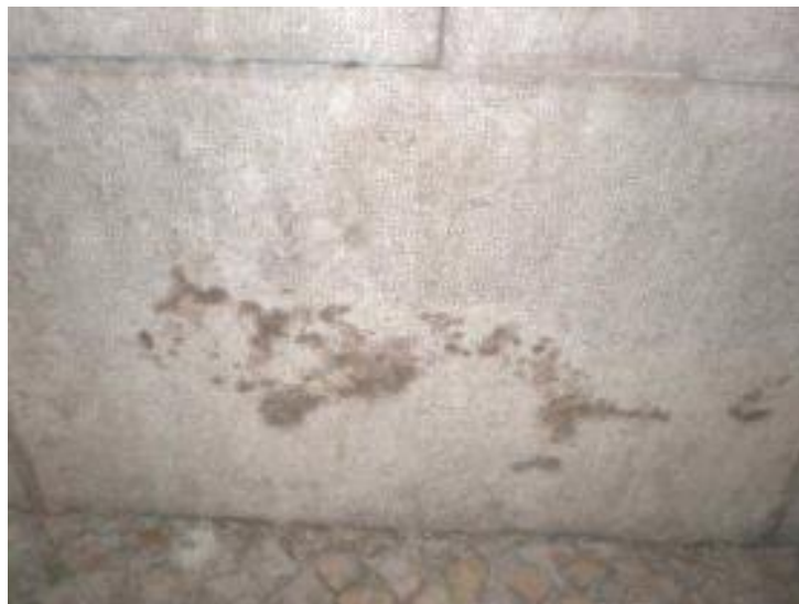
Figura 11 - Manchas associadas a fungos
