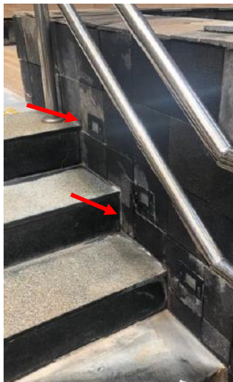
Figura 21 - Fissuras no revestimento
