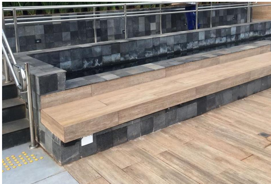
Figura 19 - Alterações monocromáticas, fissuras e eflorescências
