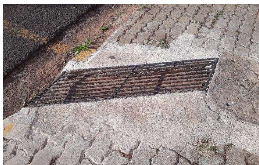
Figura 34 - Exemplo de problema associado ao indicador Presença de grelhas. Face de Quadra do Centro cultural Esther Pires Novaes (313B)
