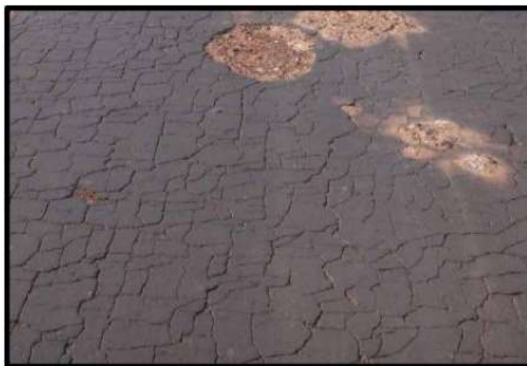
Figura 10 - Fadiga do revestimento do pavimento asfáltico.
