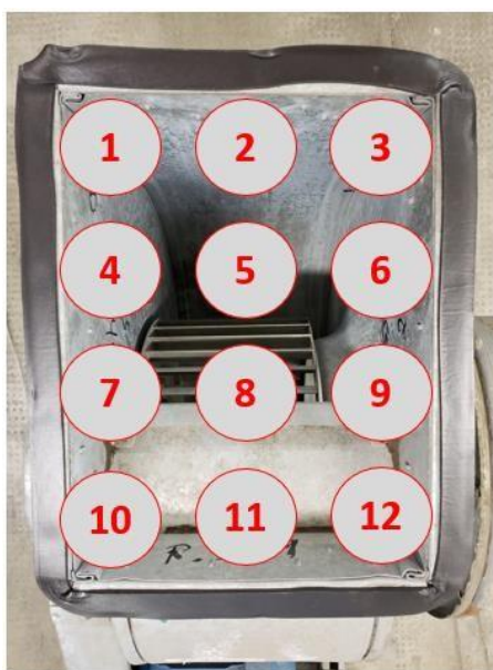
Figura 9 – Pontos de medição na saída do ventilador
