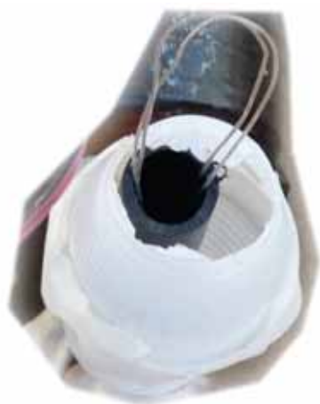
Figura 16: Blindagem implementada nos sensores de temperatura.
