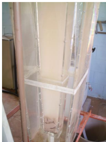
Figura 4.5 – Câmara de floculação, formação da manta de lodo.
