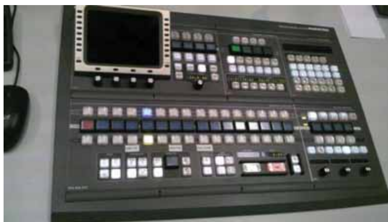
Figura 27 - Hardware da Sala Master Final
