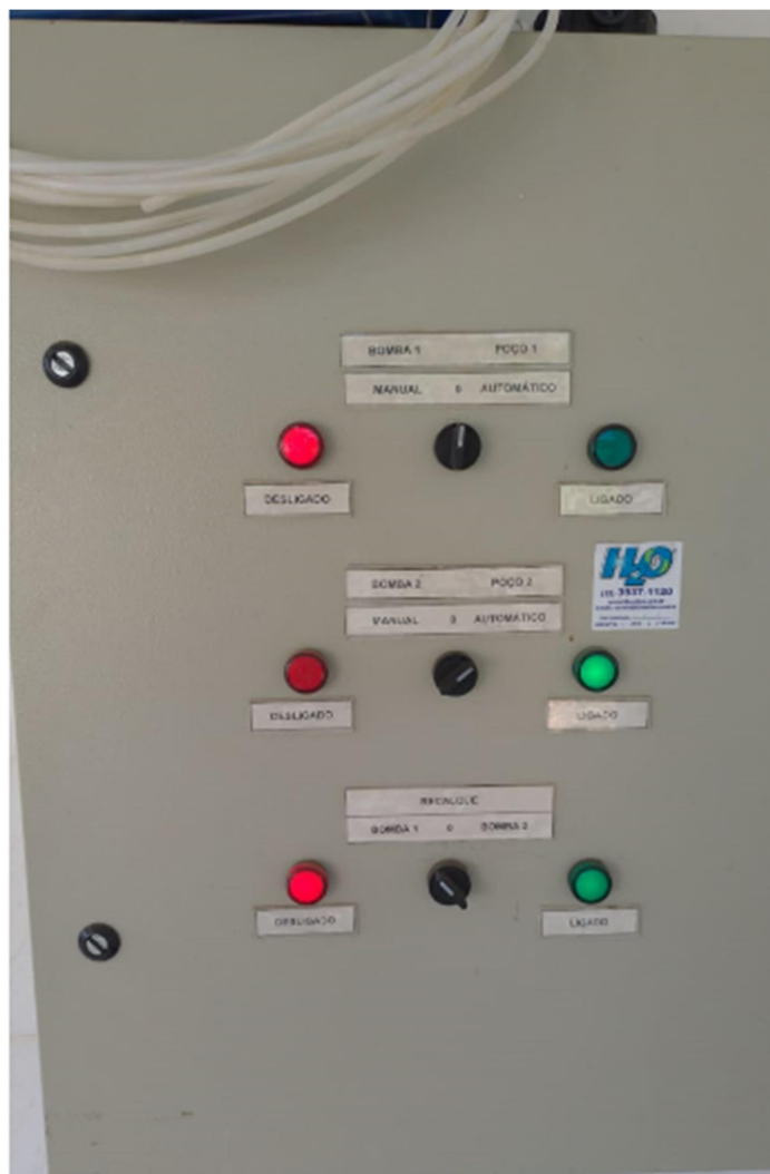
Figura 10 – Painel de controle das bombas hidráulicas
