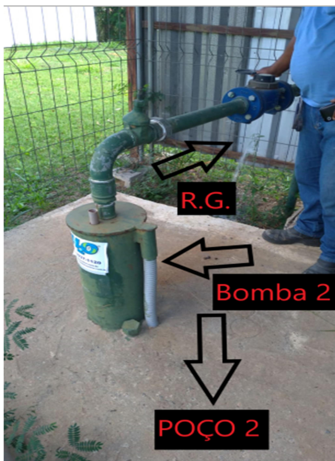
Figura 9 – Poço artesiano 2 e Bomba hidráulica 2
