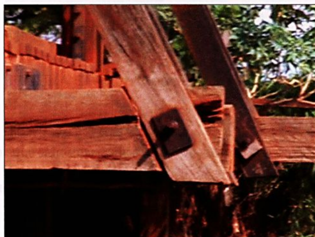
FIGURA 52 – Fendilhamento da transversina
