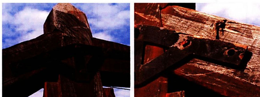
FIGURA 44 – Ligação intacta e ruída
