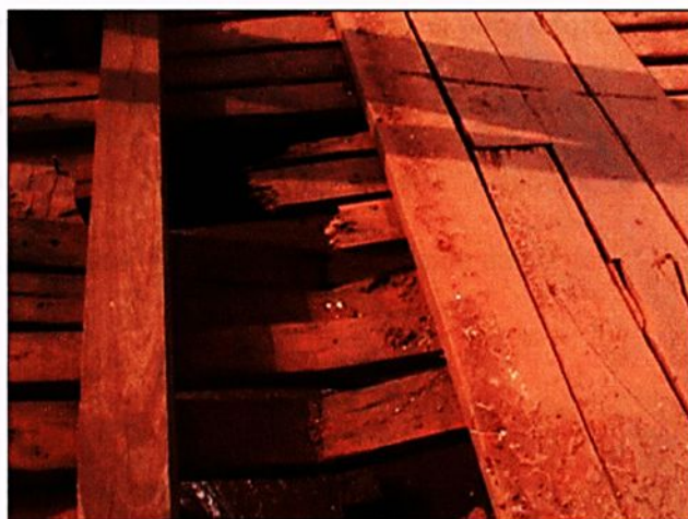
FIGURA 51 – Ruína do tabuleiro
