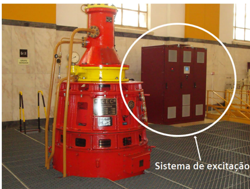
Figura 24 - Painel compondo o sistema de excitação e regulação de tensão.
