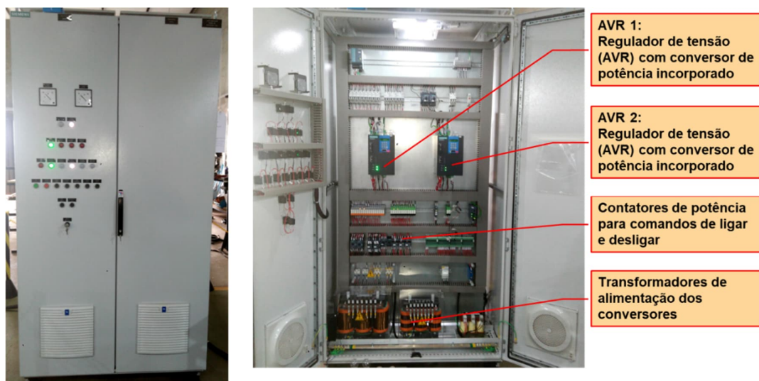
Figura 33 – Exemplo de um painel elétrico compondo o sistema de excitação brushless e regulação de tensão, fabricante Siemens Energy Brasil.
