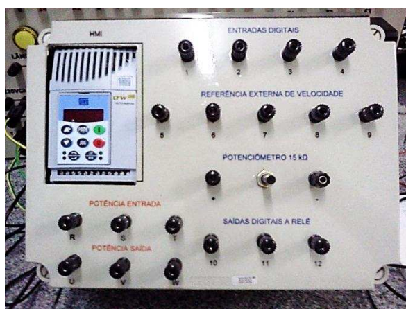
Figura 13: Caixa de ligação Inversor de Frequência.
