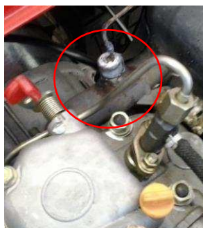
Figura 5 - Termopar do tipo K instalado no duto de escape do motor.
