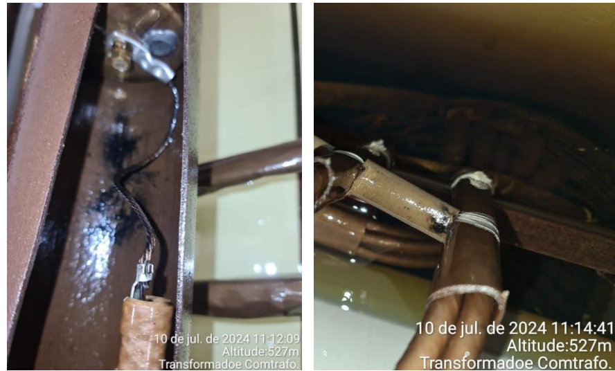
Figura 21 - Indícios de papel queimado no Transformador Elevador.
