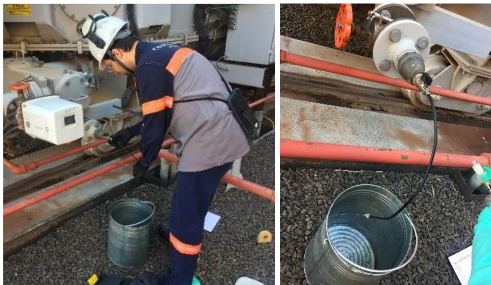
Figura 4 - Conexão de mangueira para coleta.
