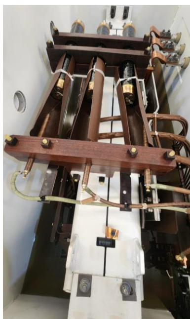
Figura 23 - Visão geral do transformador após manutenção.
