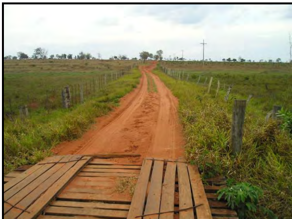
Figura 6.43 Estrada em área à jusante na bacia hidrográfica do ribeirão Palmito. Fonte: Arquivo pessoal (2006).
