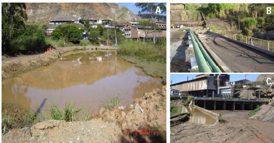
Figura 12 - Em A bacia de decantação de sedimentos, em B e C silo utilizado na secagem de sedimento. (Fotos do autor).
