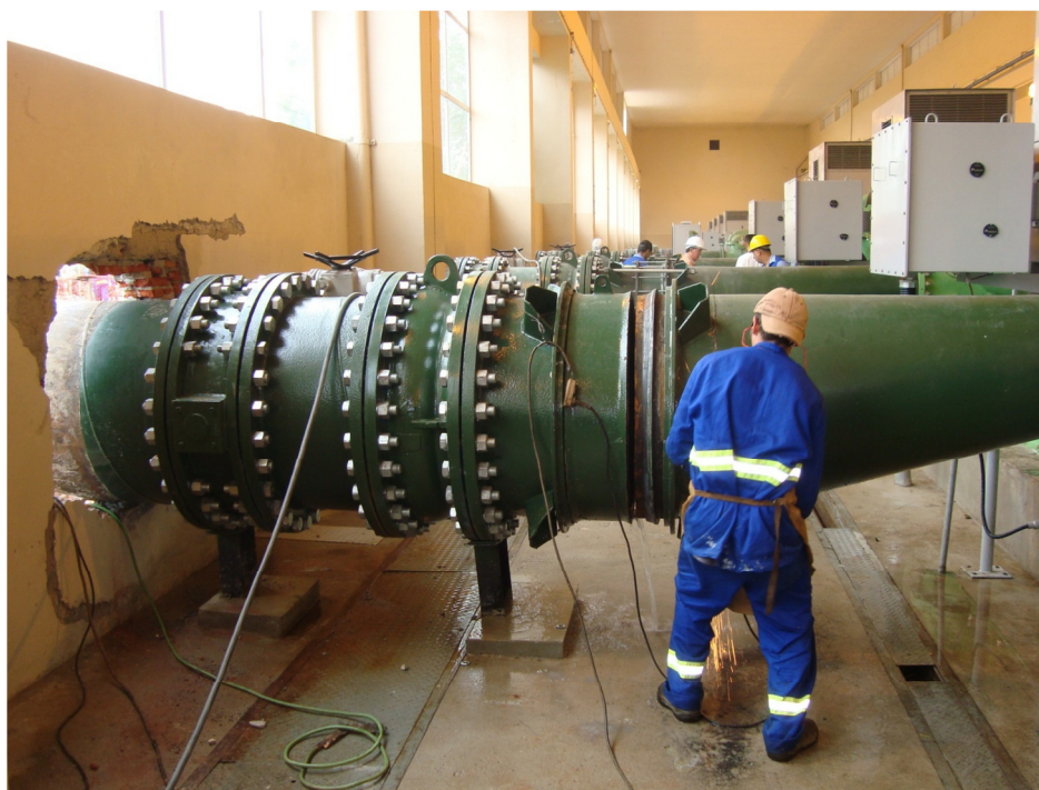
Figura 8. Resultado de golpe de aríete devido à vibração da tubulação em contato com a parede da casa de bombas. Fonte: SABESP.
