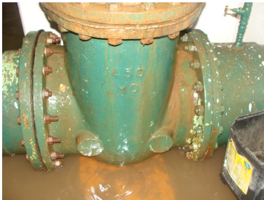
Figura 9. Registro de parada de ferro fundido, diâmetro 400 mm com vazamento após golpe. Fonte: SABESP.
