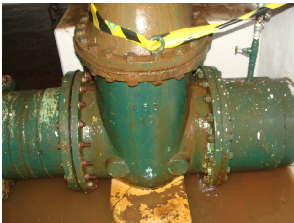
Figura 12. Detalhe 3: trinca bloco de ancoragem do registro de parada. Fonte: SABESP.
