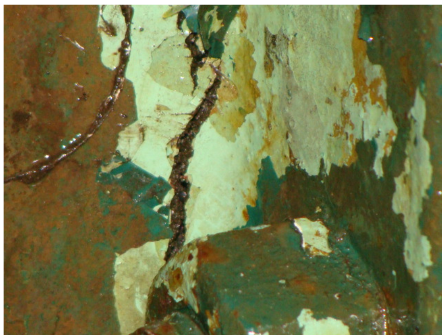
Figura 10. Detalhe 1: trinca registro de parada. Fonte: SABESP.
