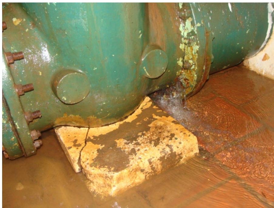
Figura 13. Detalhe 4: Trinca no bloco de ancoragem e vazamento no flange do registro de parada. Fonte: SABESP.
