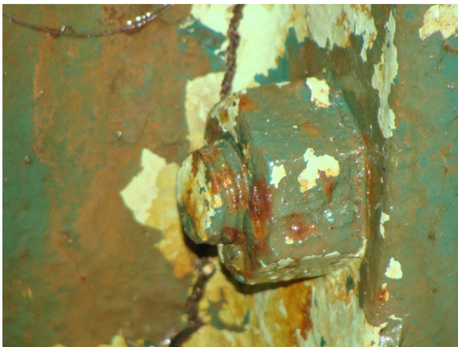
Figura 11. Detalhe 2: trinca registro de parada. Fonte: SABESP.
