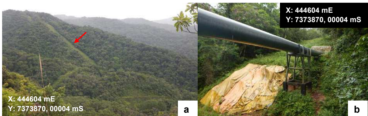
Figura 33. Duto OSVAT na unidade 5. (a) indicação da faixa dutoviária; (b) Passagem aérea. Foto: Arquivo pessoal Fábio Augusto Gomes Vieira Reis.
