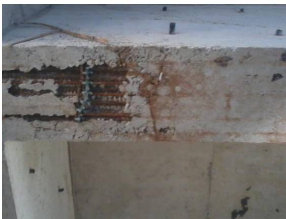
Figura 30 – Processo de corrosão na armadura exposta.
