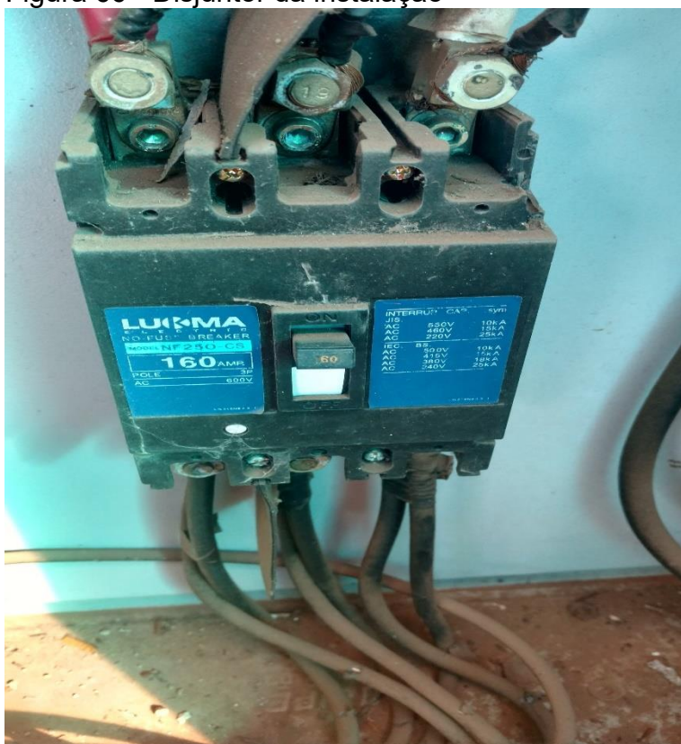
Figura 66 - Disjuntor da instalação
