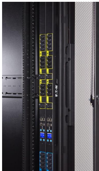
Figura 15 - Unidade de Distribuição de Energia (PDU).
