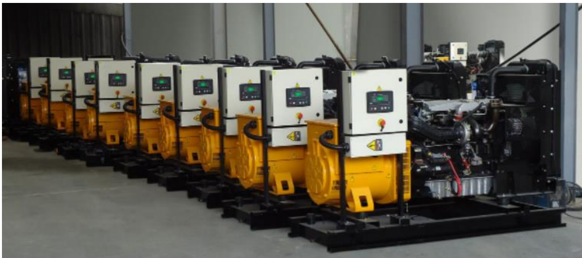
Figura 14 - Grupo de Geradores.
