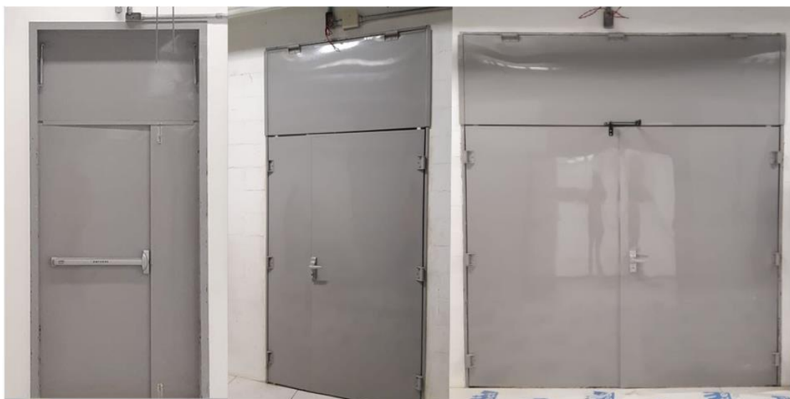
Figura 40 - Portas corta fogo.
