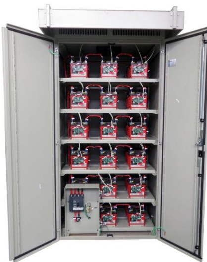
Figura 13 - Banco de Baterias.
