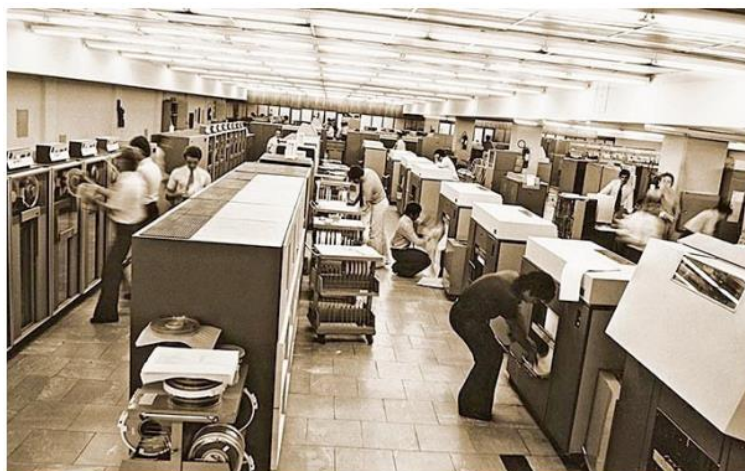
Figura 1 - Centro de Processamento de Dados (CPD) no passado.
