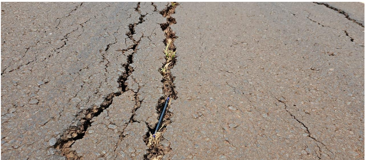
Figura 8.0 - Exemplo de trincas severas.
