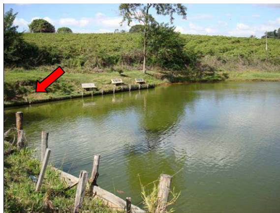
Figura 22. Ocorrência de erosão no entorno do tanque no PP4 (Foto: Ana Paula Nunes).
