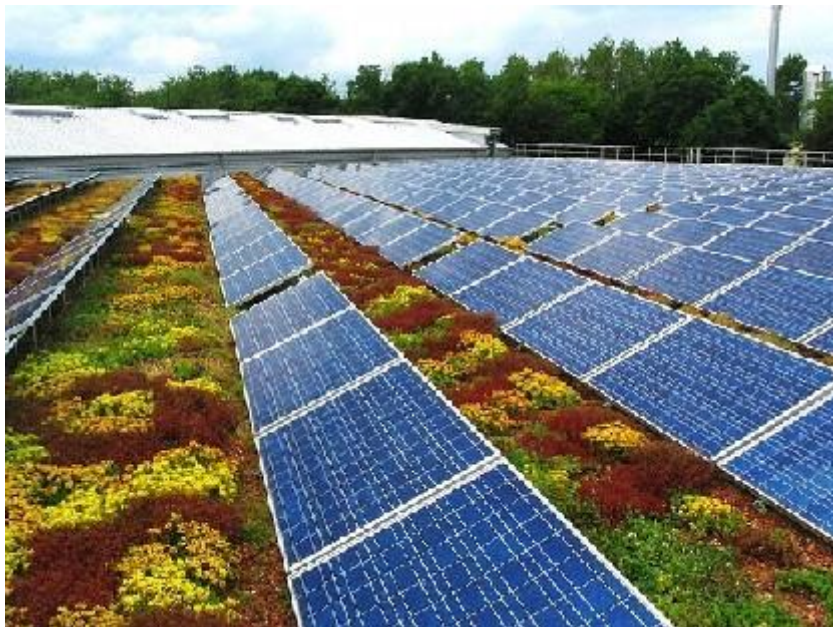
Figura 10 – Pannel Fotovoltaico em Telhado Verde
